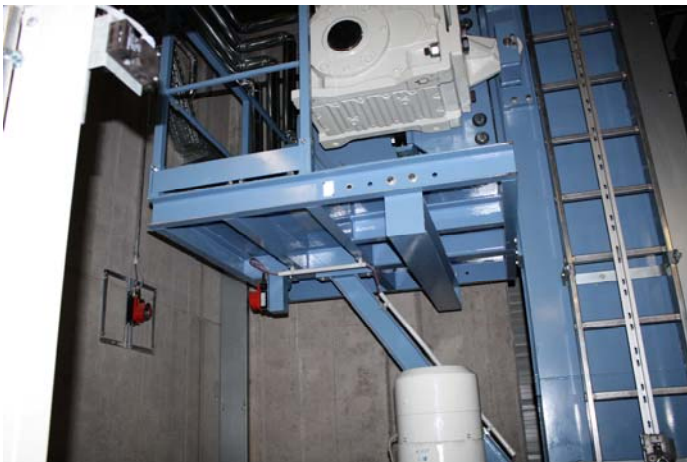
Bild 3: Die Datenübertragungs-Lichtschranke DDSL 200 überträgt die Positionsdaten des RBGs direkt an die Anlagen-SPS.
