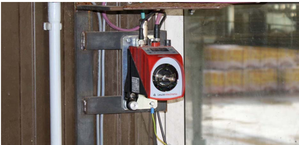
IMG_1567.jpg: Distanz-Messgeräte überwachen die Positionierung des Portalkrans und den gleichmäßigen Antrieb seiner Achsen.
